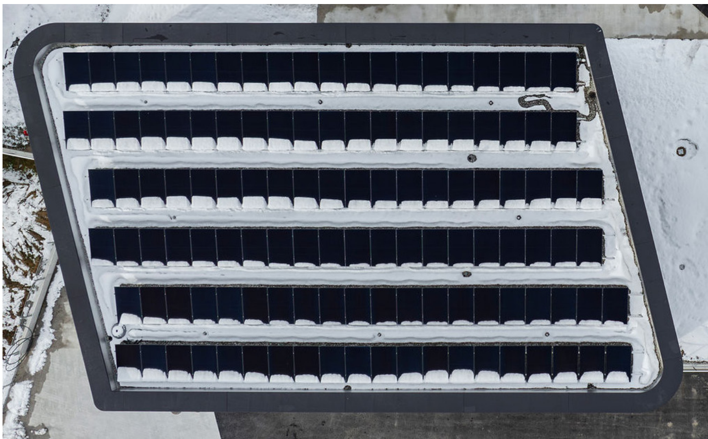
Abb. 2: Das Dach der endigo Holding AG ist grosszügig mit PV-Modulen bedeckt.
